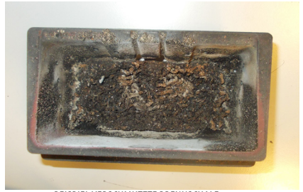
BEISPIEL VERSCHMUTZTE BRENNSCHALE
