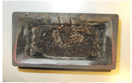
BEISPIEL VERSCHMUTZTE BRENNSCHALE
