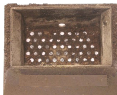
Kohlenbecken, das gereinigt werden muss, mit Löchern, die durch Asche verstopft sind
